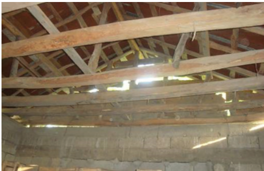
شکل ۳-۴۴- سقف نامناسب و بدون عایق بندی
